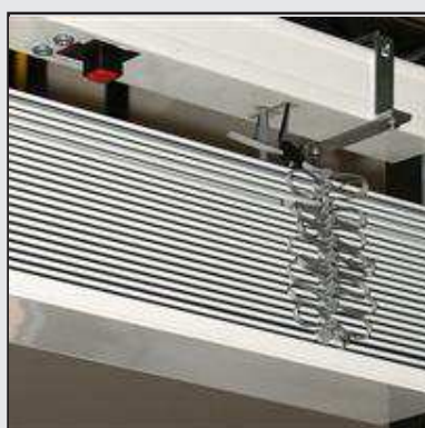
Detalle de soporte y de la cortina recogida
